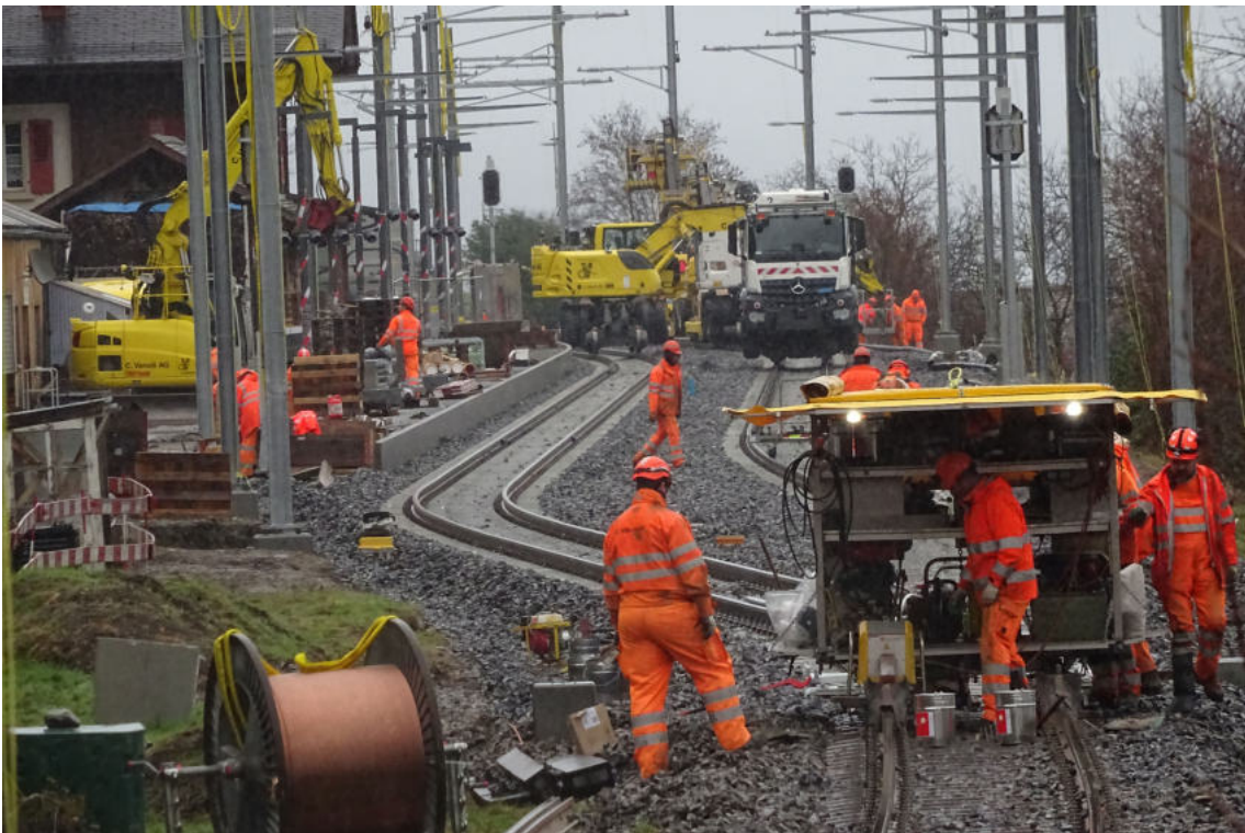
Der Schienenstoss zur Weiche wurde 'optimiert' (verschliffen) ...
