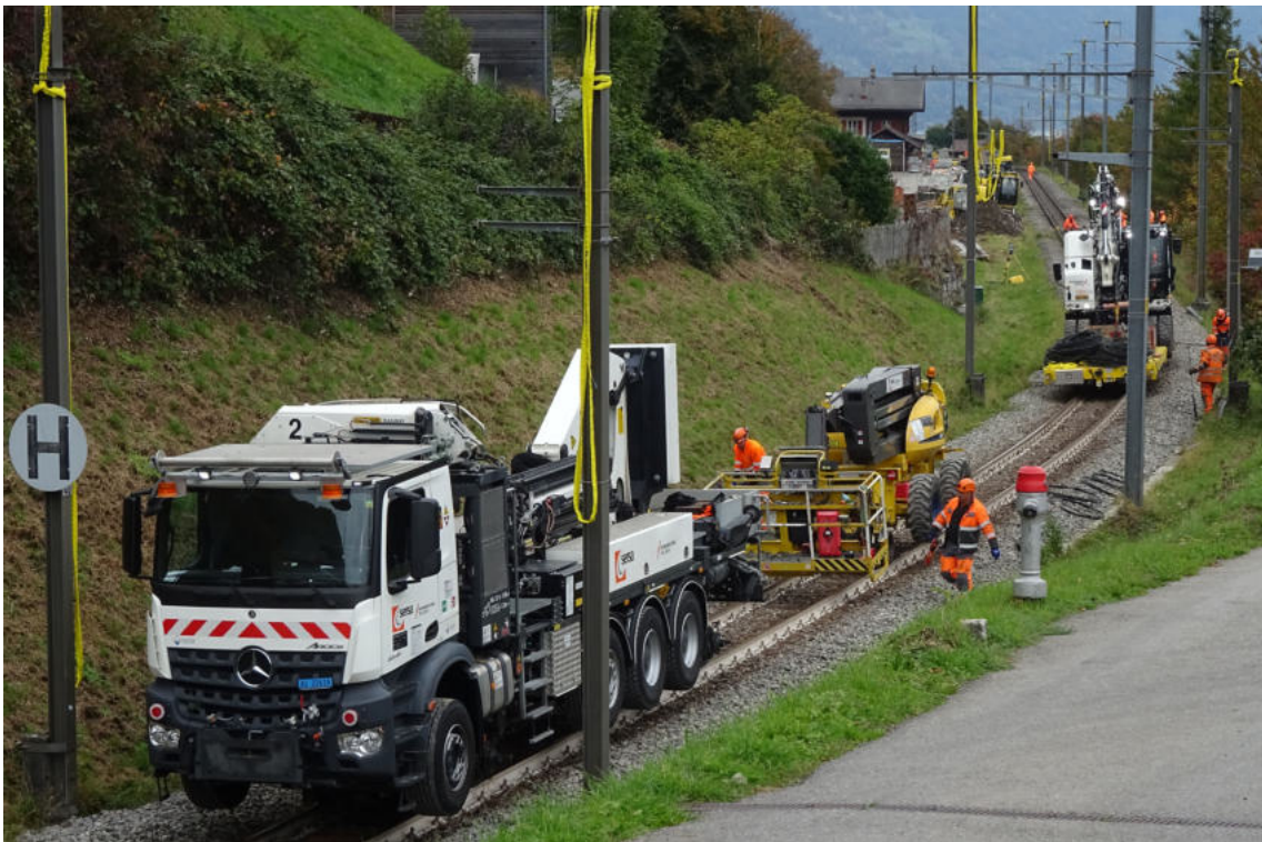
Dann wurden die Masten fürs 'Ziehen' vorbereitet. Der rechts vom Hydranten weigerte sich standhaft! (Er war danach immer 'störend' im Bild.) Er verblieb und wurde integriert.
